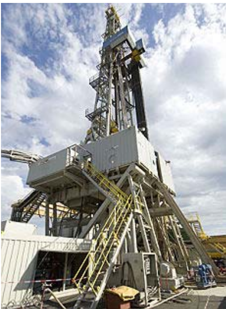
Un impianto geotermico
